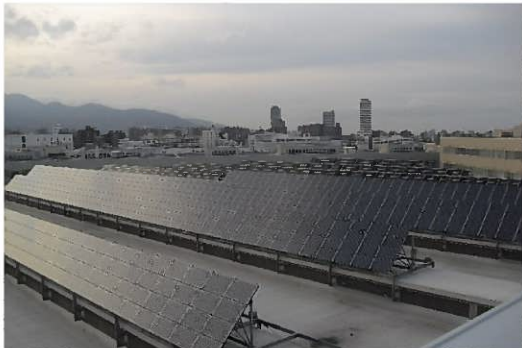
一般会計の事業で太陽光発電装置を設置
